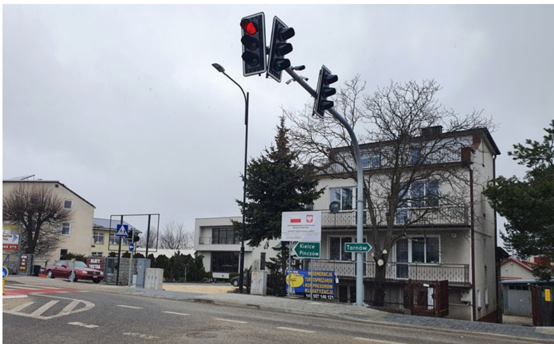
Zdjęcie 7: Kamery zainstalowane w ramach projektu na maszcie sygnalizacji świetlnej na skrzyżowaniu ul. Partyzantów i Grotta w Busku-Zdroju, fot. UMiG w Busku-Zdroju.
